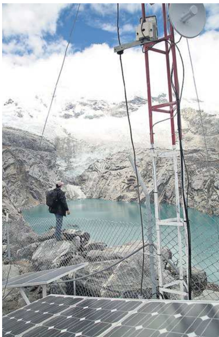
TECNOLOGÍA. Sensores instalados en la misma laguna 513 son los que alertan de una posible avalancha.
